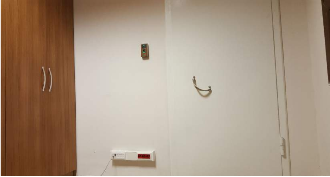
(Yeni Sunucu Odası-Giriş)
